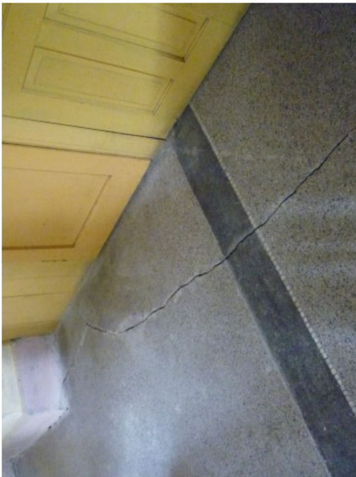
07_trhlina v terazzu.jpg
